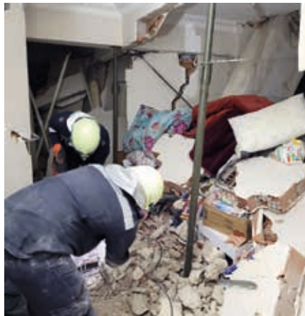
Abb. 2: Deckendurchbruch (Bild: Kurt Kerschbaumer)
