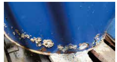
Abb. 3: Korrodierter Chemikalienbehälter (Bild: Agnes Wildauer)
